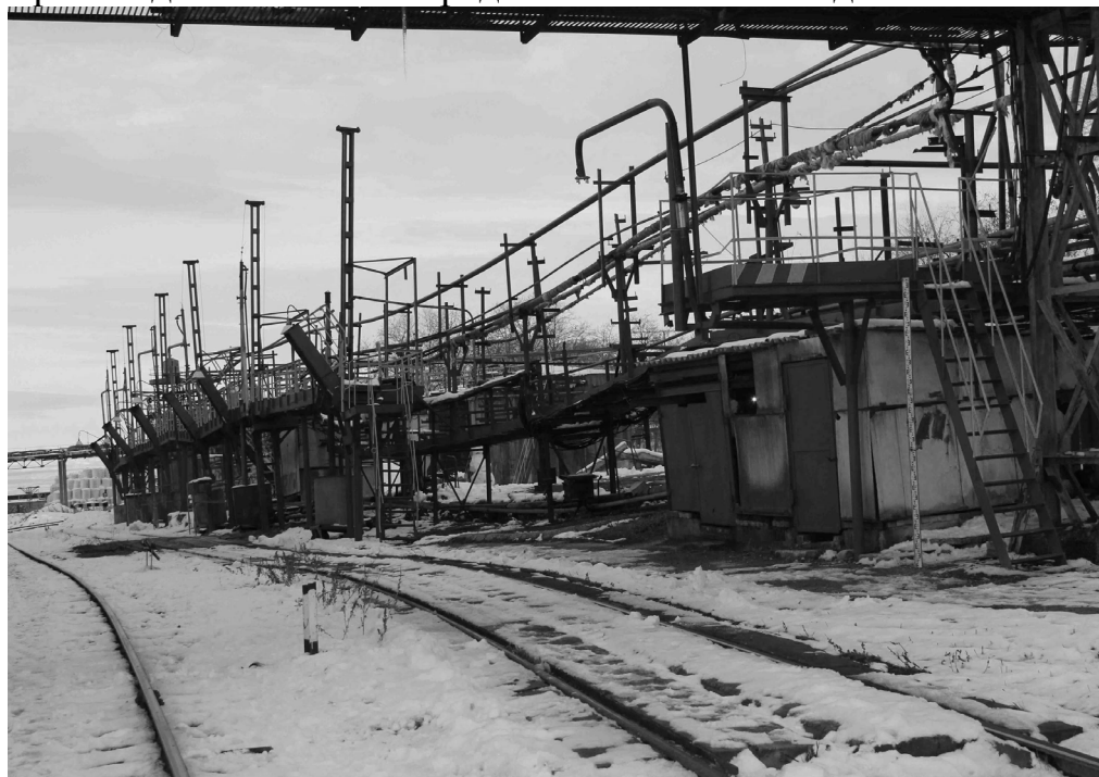
Рис. 1. Железнодорожная сливная эстакада ОАО «ГМЗ» (общий вид)
