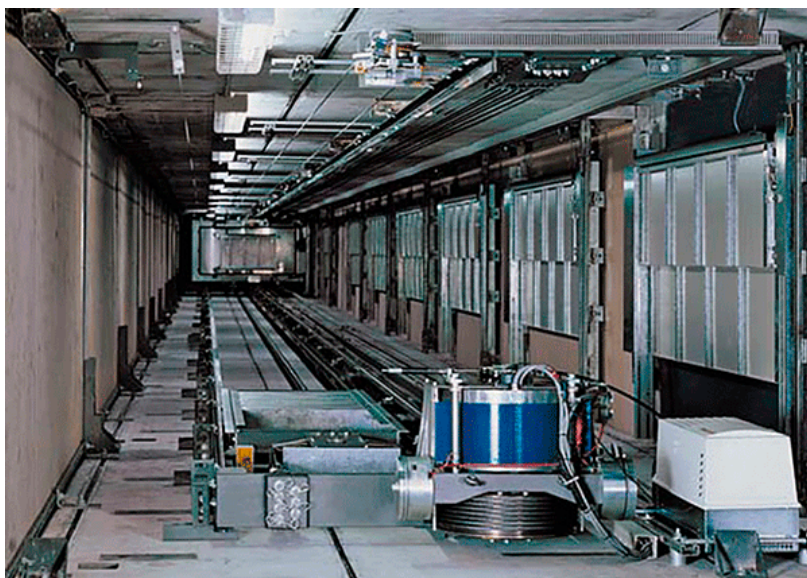
Рис. 5. Электропривод лифтового оборудования
