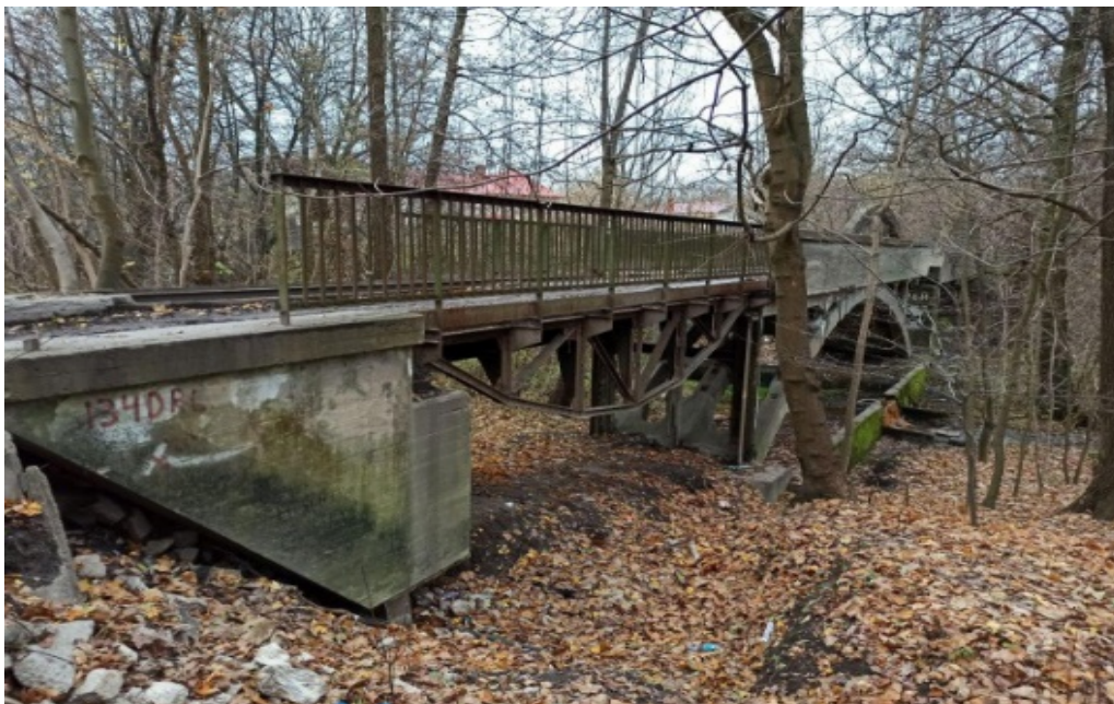
Рис. Мостовой переход через приток ручья Гагаринский, расположенного по адресу: Калининградская область, г. Калининград. Фото из интернет источника http // www.kaliningrad.ru
