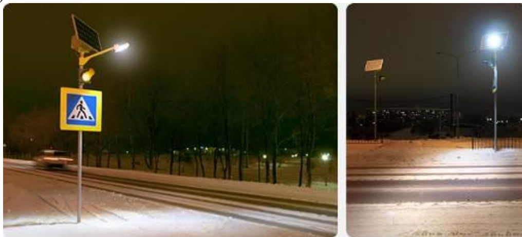
Рис. 3. Светофор со светильником для освещения зоны пешеходного перехода
