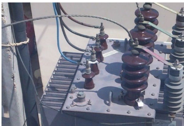
Рис. 1. Трансформатор с сломанным изолятором
