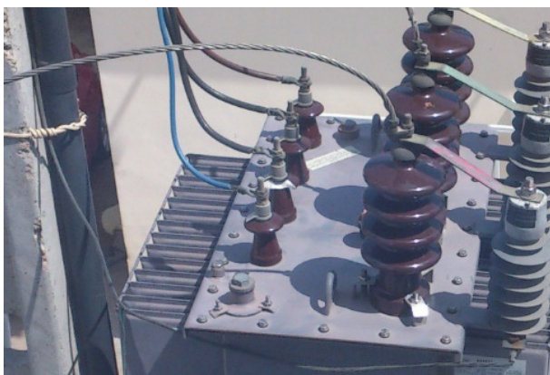
Рис. 1. Трансформатор с сломанным изолятором
