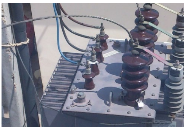
Рис. 1. Трансформатор с сломанным изолятором
