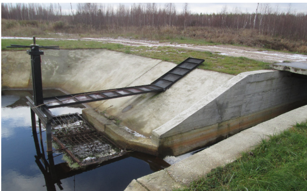
Рис. 2. Водопропускное сооружение через грунтовую дамбу, совмещающее шахтный трубчатый водосброс и поверхностный канал
