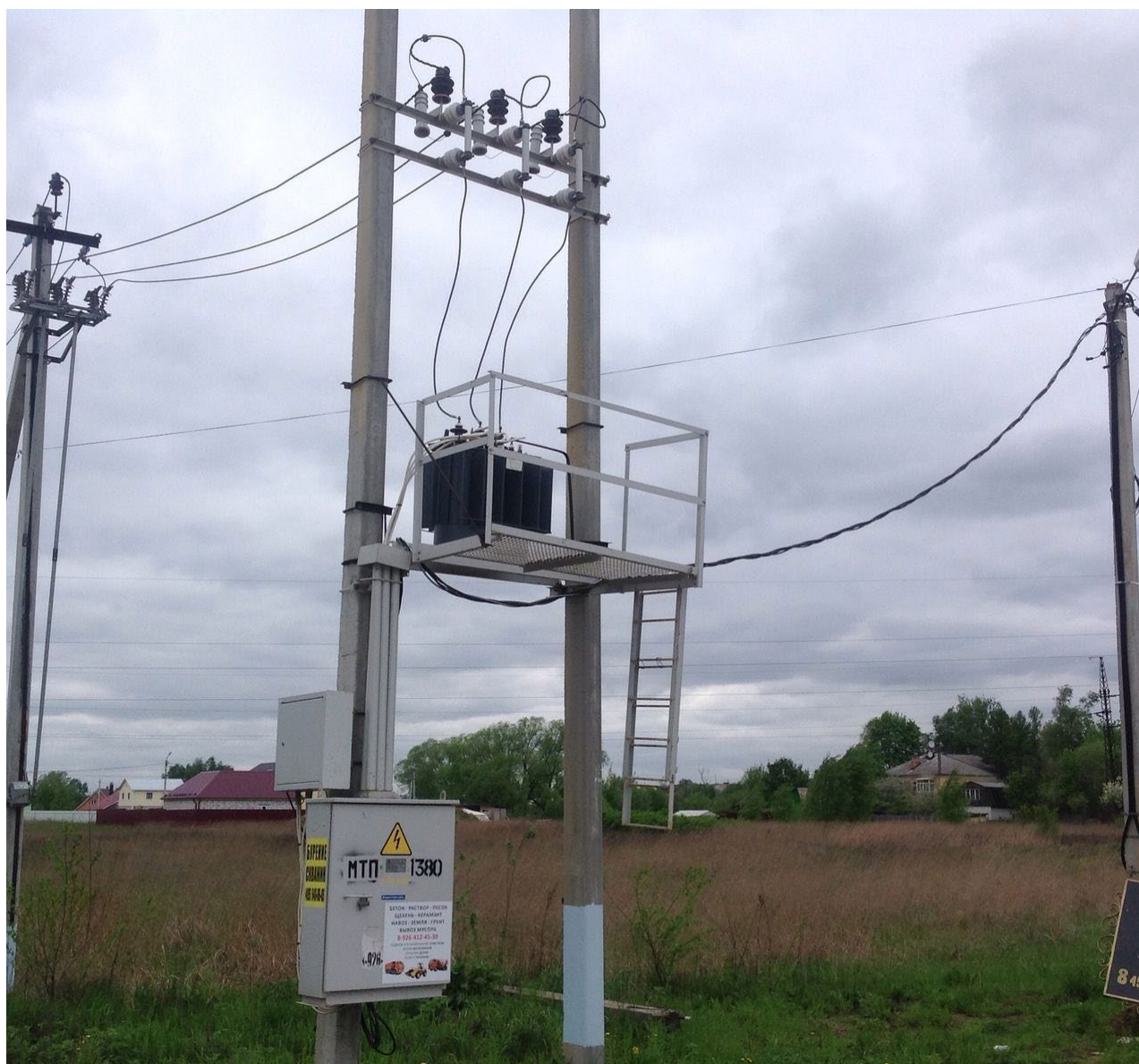
Рис. 1. Столбовая трансформаторная подстанция
