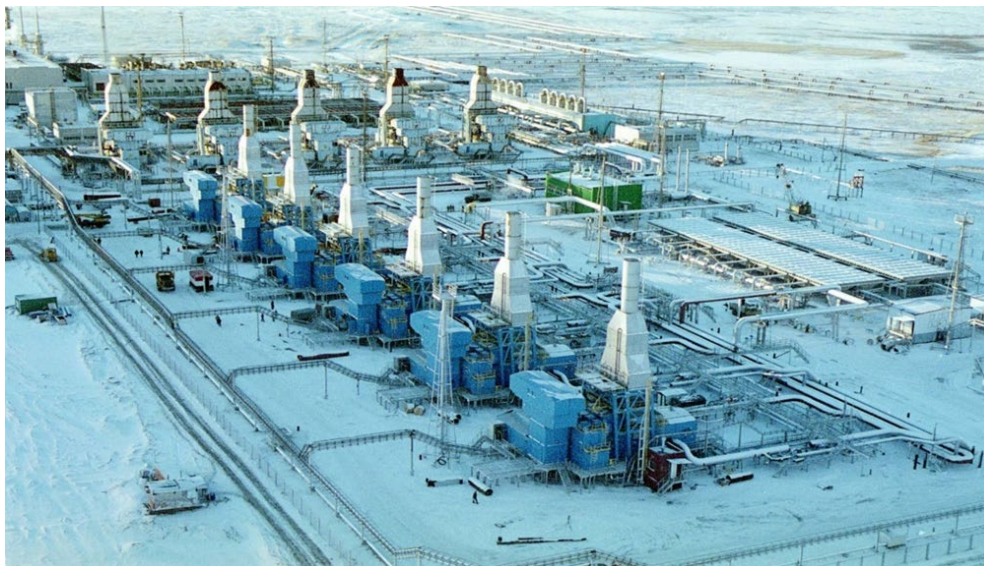
Рис. 2. Дожимная компрессорная станция
