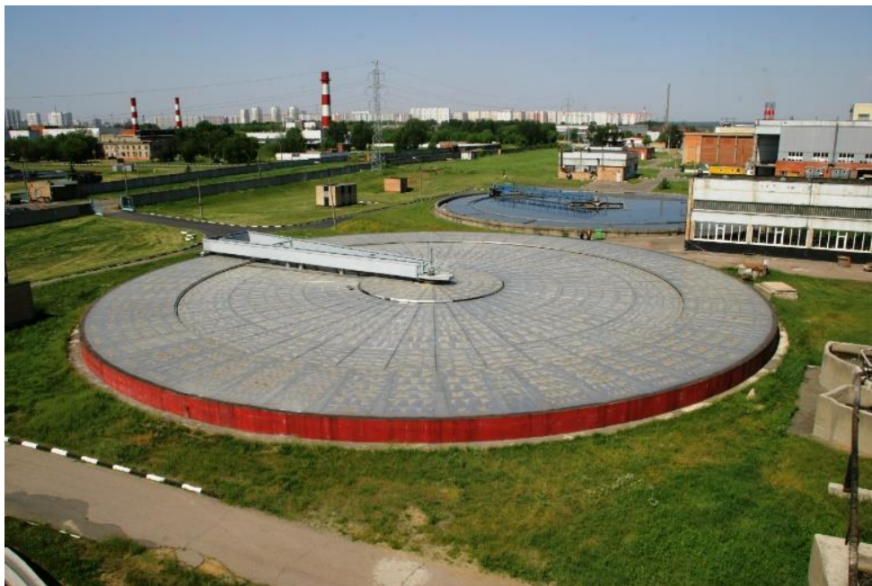
Рис. Перекрытый первичный отстойник ЛОС [6]
