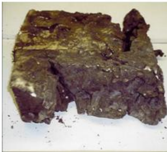
Рис. 2. Деградация за короткий срок службы вследствие брака на производстве плит ППС
