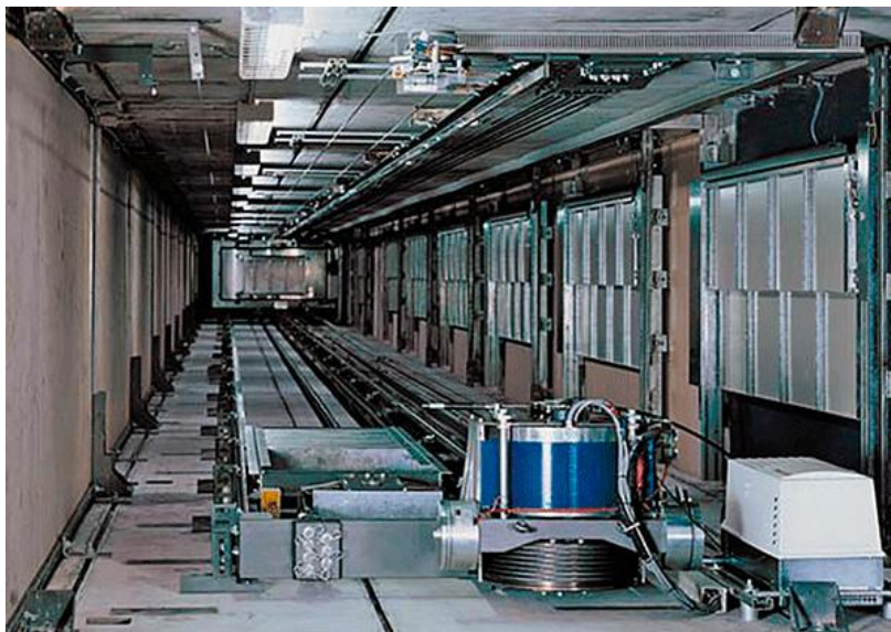
Рис. 5. Электропривод лифтового оборудования
