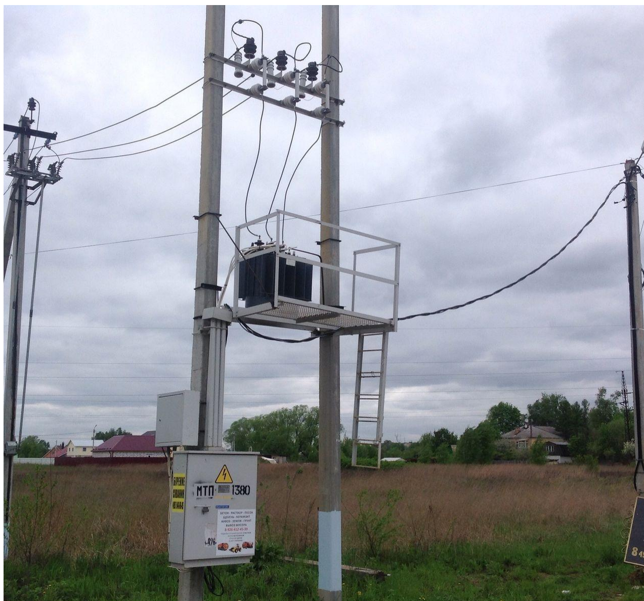
Рис. 1. Столбовая трансформаторная подстанция
