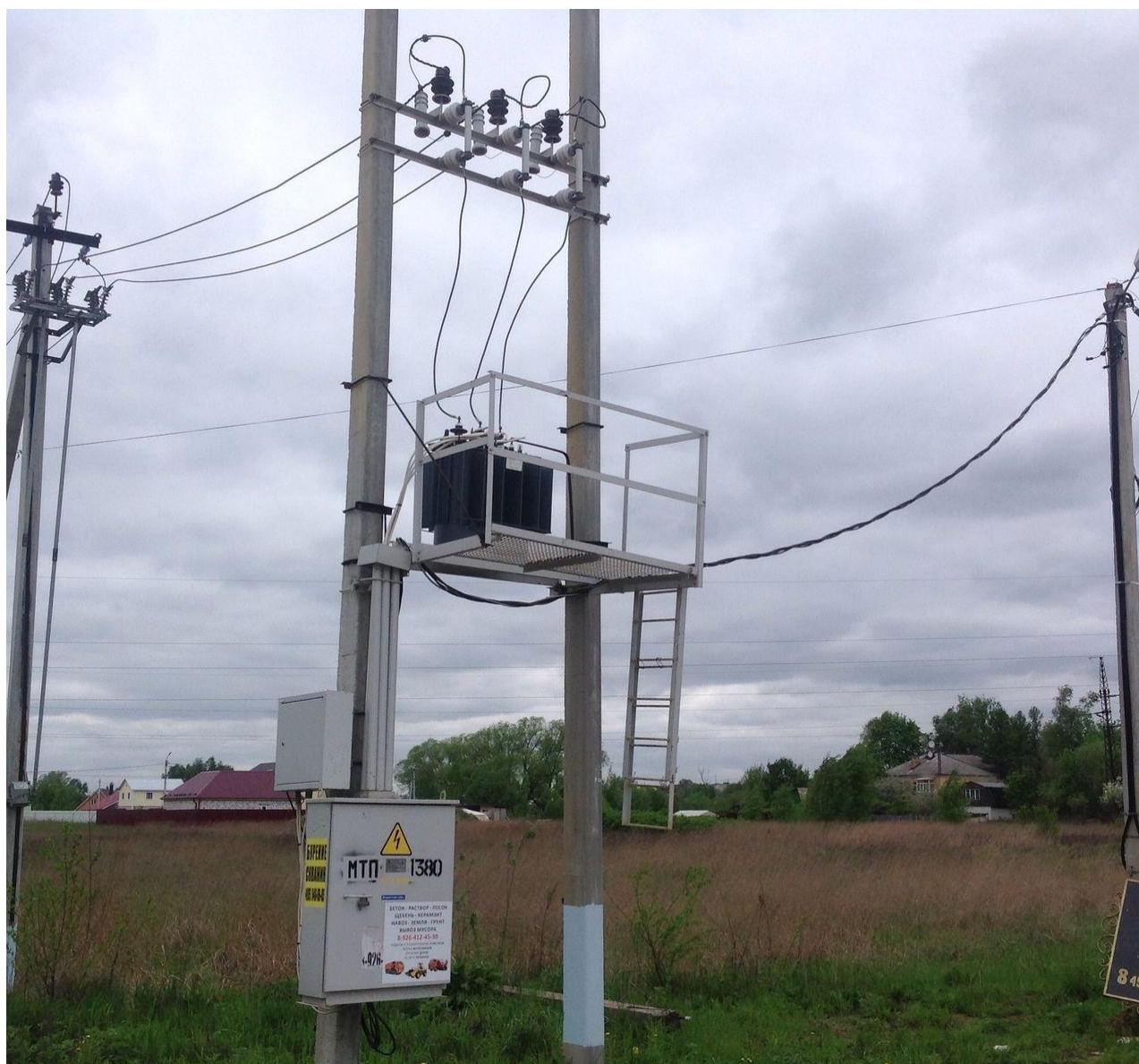
Рис. 1. Столбовая трансформаторная подстанция
