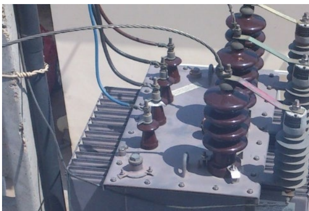
Рис. 1. Трансформатор с сломанным изолятором
