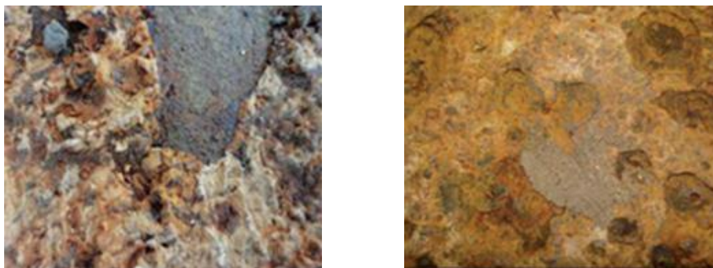
Рис. 2. Фрагменты внутренней поверхности трубопроводов
