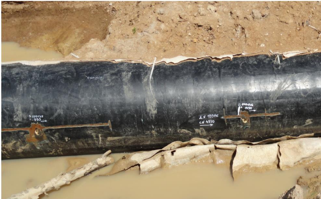
Рис. 3. Стальная труба трубопровода с рисками на поверхности
