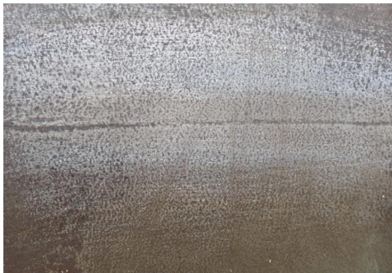
Рис. 2. Дефект риска на поверхности стальной трубы
